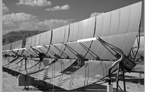
FIGURA 14.13 Estación de generación de energía solar de California.
