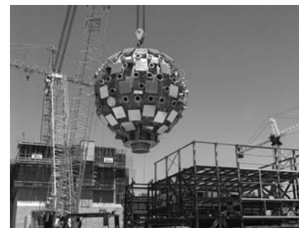
FIGURA 25.17 Instalación de la cámara objetivo para el reactor de fusión inercial NIF. La cámara incluye las aberturas para los 192 haces de rayos láser convergentes.
